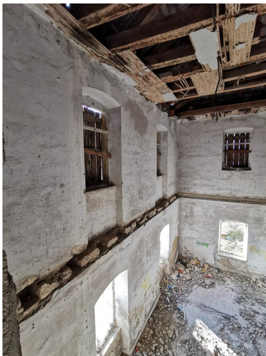
Prikaz urušene međukatne konstrukcije iznad prizemlja
