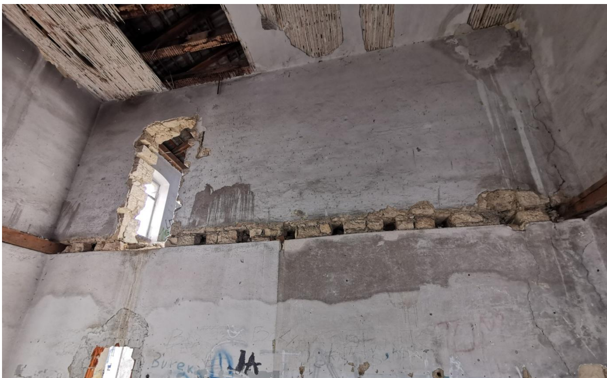
Slika 9. Ostatci utora za grede međukatne konstrukcije od drvenih greda
